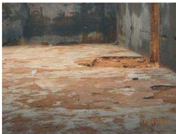
Die Fußböden haben Löcher und Wasserschäden
